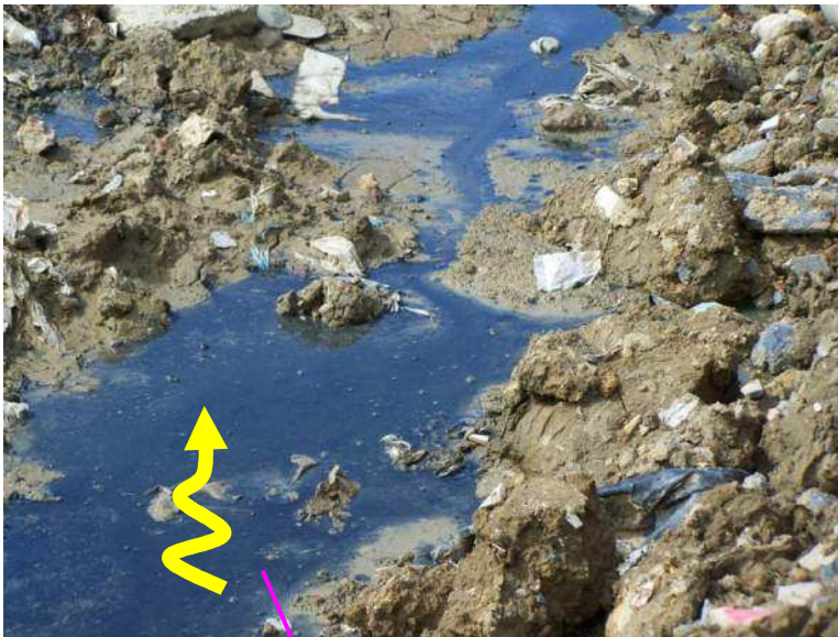
Surgencia aparecida en obra
